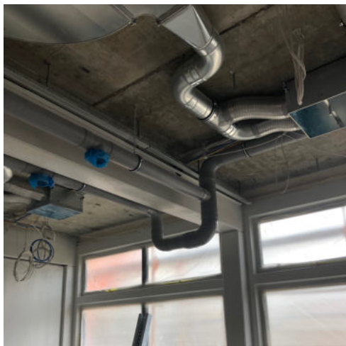
nicht immer richtig installiert!
