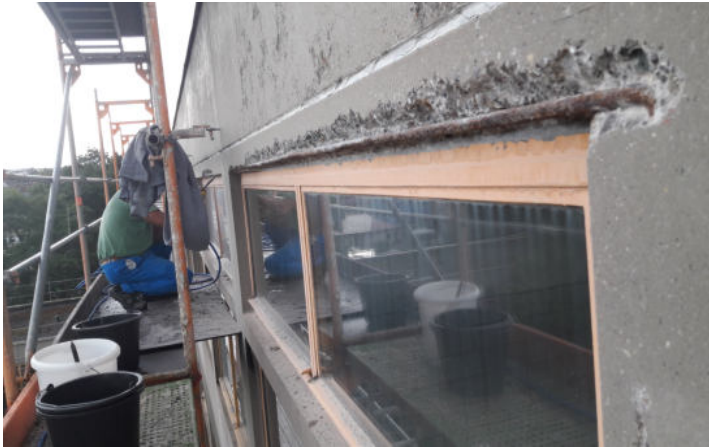
Bewehrung wird freigelegt
