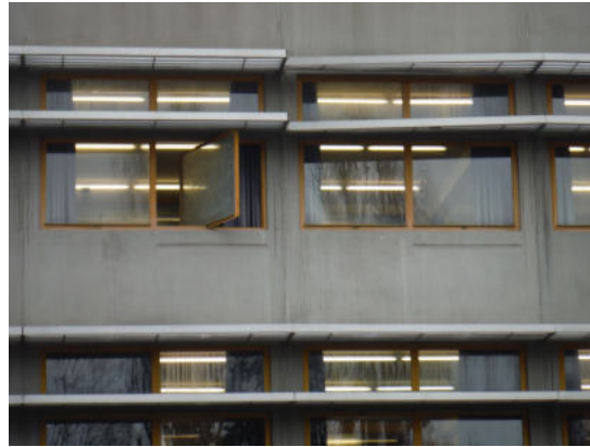
undichte Fenster sehr hohe Energiekosten Bauschäden an der Fassade und Sonnenschutz
