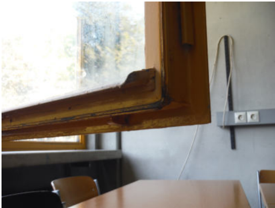
Bestand: umlaufend Fensterdichtungen beschädigt
